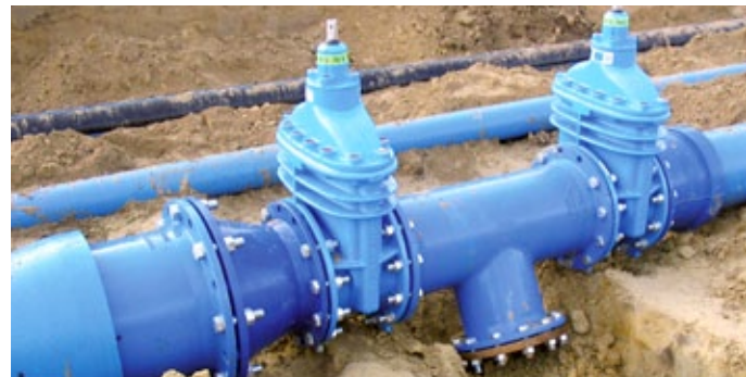
Brandvattenledning sammankopplat med ventiler
