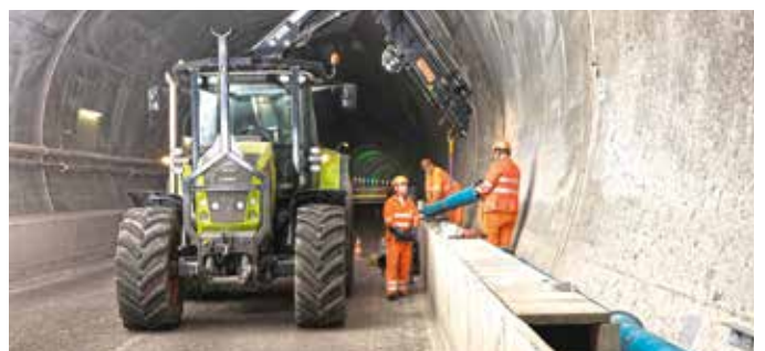
Brandvattenledning i tunnel.
